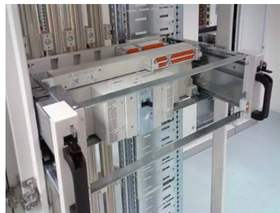
BASE IS 333 EN POSITION "DÉBROCHÉ"
