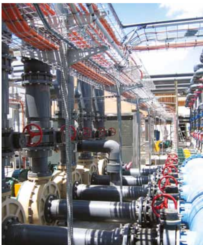
Les chemins de câbles en fil utilisés à l'extérieur dans cette installation pétrolière permettent le supportage de câbles adaptés aux conditions externes
