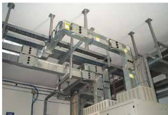
^ Exemple de cheminement de canalisations électriques préfabriquées et de chemins de câbles
