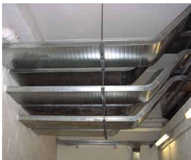
^ Chemins de câbles métalliques avec traversées de paroi
