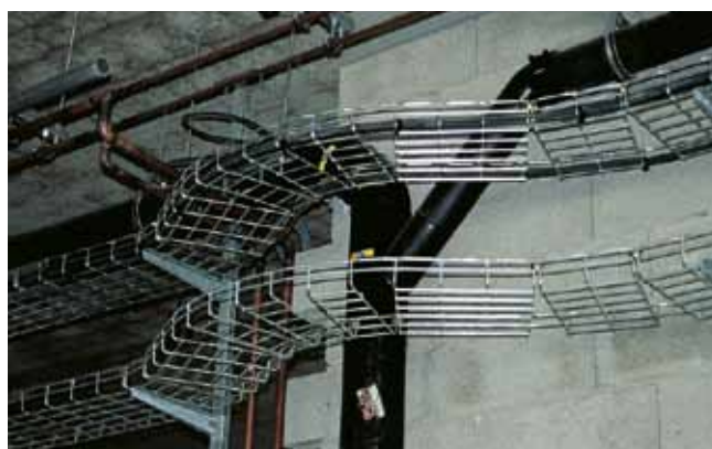
^ La configuration des locaux, les obstacles, la cohabitation des différents réseaux entraînent des cheminements parfois complexes
