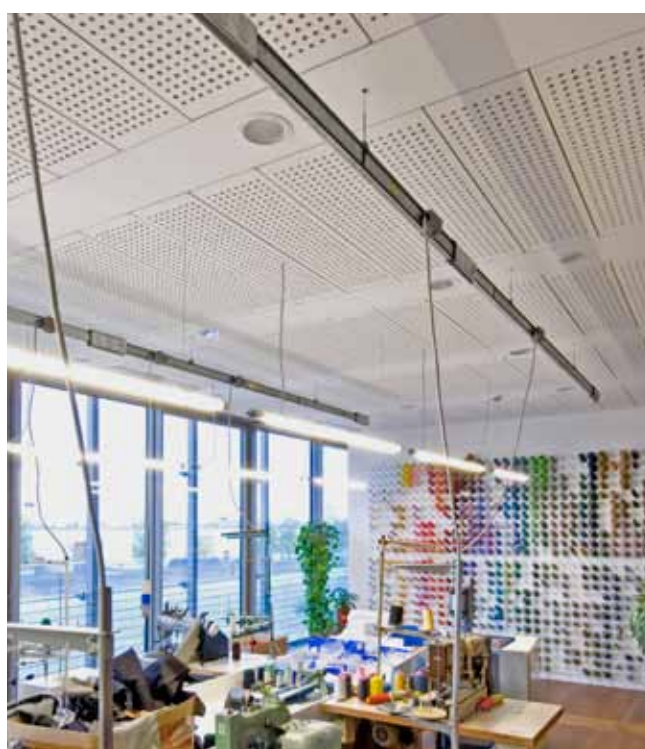
^ Canalisations préfabriquées Legrand LB de petite puissance dans un atelier de couture
