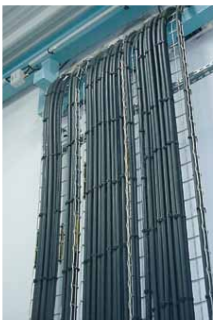
Disposition soignée des câbles respectant à la fois les règles de groupement et les précautions vis-à-vis de l'incendie
