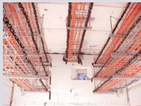
Chemins de câbles Cablofil à l'intérieur du four avant l'essai
