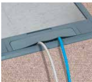
Flexibele uitvoer van de kabels.
